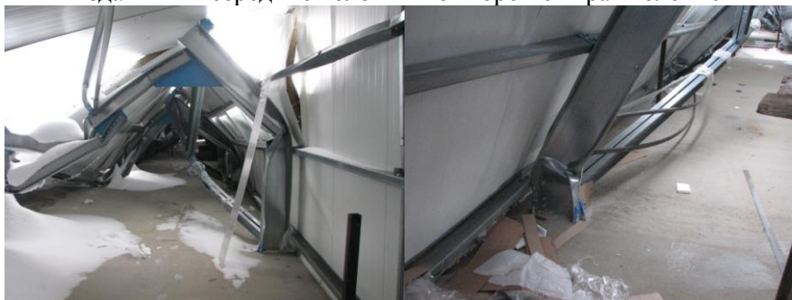
Рис. 6. Искривление металлических «доборных» вставок
